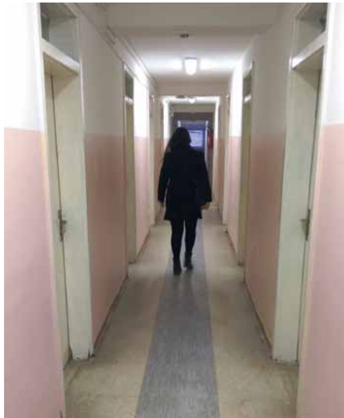
Im Flur riecht es nach Kanalisation.
